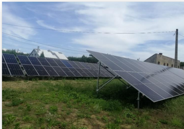
Zdjęcie 15: Instalacja fotowoltaiczna na terenie gminnego ujęcia wody przy ulicy Dworcowej w Pankach
